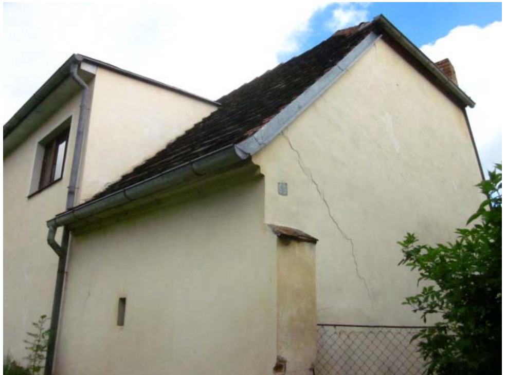
trhlina v jižním rohu objektu RD č.p. 60
