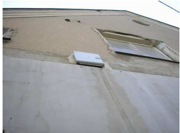
Nevyhovující stav fasády RD.
