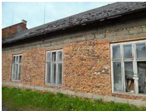
pohled ze silnice - rozbitá okna, klempířské kce
